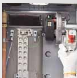
Apertura sistema combustione completo
