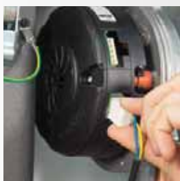
Disconnessione elettrica ventilatore
